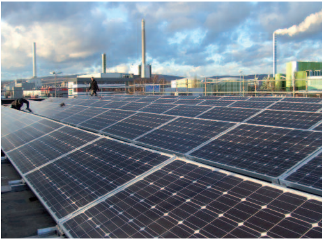
Erzeugung und Nutzung von Solarenergie
