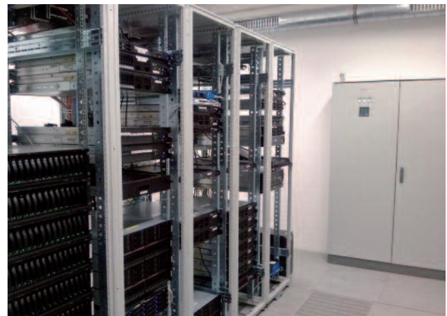
Server-Raum der Kommunale Datenzentrale
