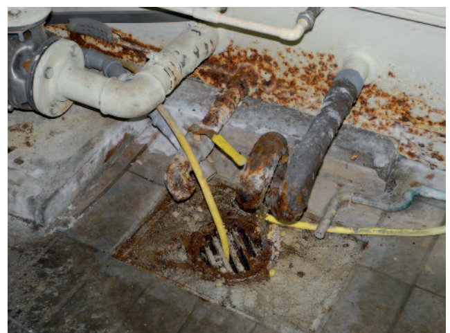
Veraltete Technik, die erneuert werden muss.
